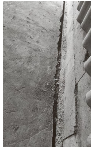
Risse, Absenkung der Betonplatte im Material Schopf
